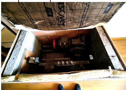
Machinerie d'ascenseur dans coffre bois : SECURITE ???
